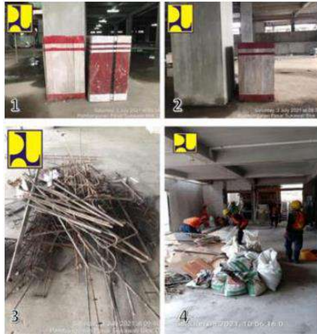
Gambar 4.33. Dokumentasi Pengumpulan Sampah Lantai Basement 1
