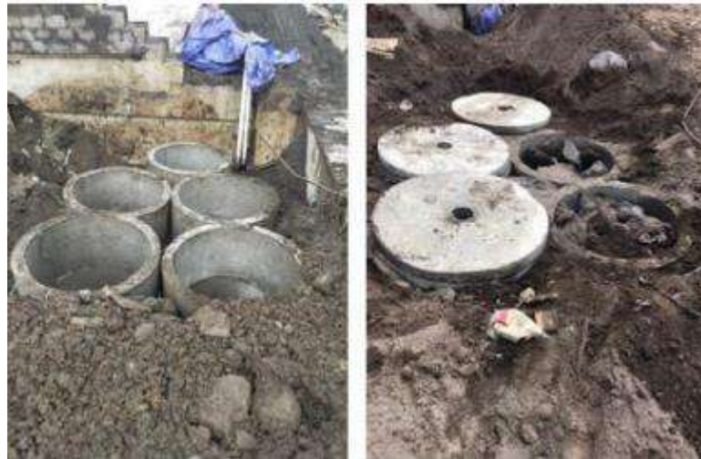
Gambar 4.60. Dokumentasi Sumur Resapan
