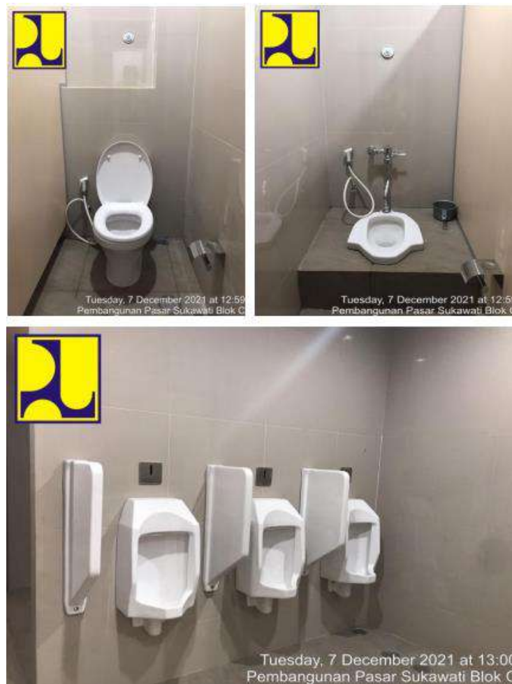
Gambar 4.142 Dokumentasi Penggunaan Material Sanitair
