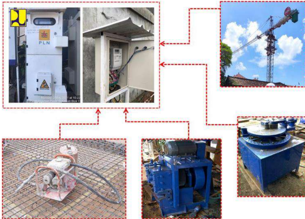
Gambar 4.69 Dokumentasi Skema Sumber Energi Listrik Peralatan
