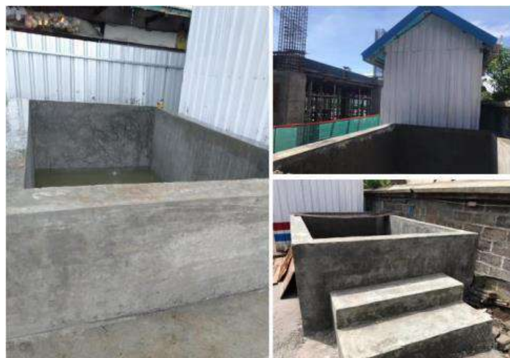
Gambar 4.115 Dokumentasi Penampungan Air Hujan
