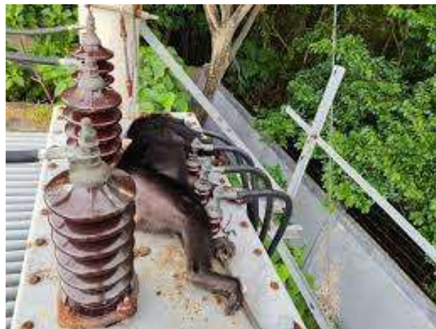
Gambar 11 Gangguan 1 Fasa Ke Tanah Akibat Monyet di Trafo Distribusi
