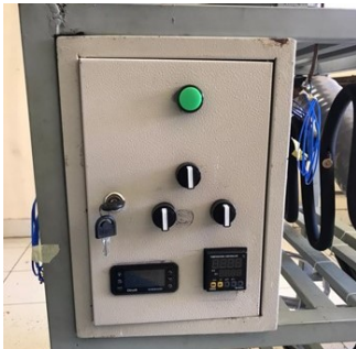
Panel kontrol dengan sistem kendali cerdas berbasis PLC
