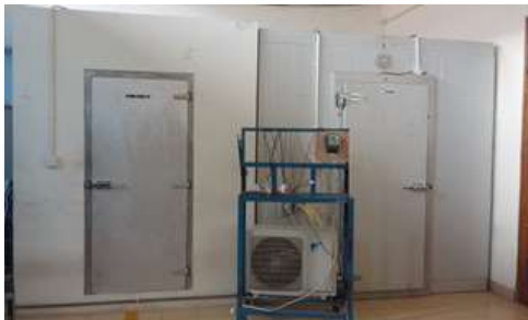
Sistem Cold room yang ada sekarang
