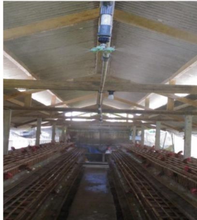
Gambar 6. Penyemprotan Disinfektan Melalui Sistem yang Telah Dipasang
