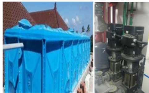
Gambar 8. Instalasi sistem suplai air bersih dan tower tank di Luna 2 Hotel Seminyak
