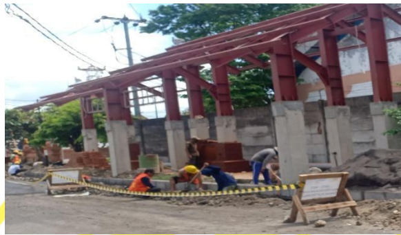
Gambar 1.3 Dokumentasi pekerja proyek yang tidak memakai APD dengan baik dan benar di area Pelabuhan Benoa Sumber : Data primer (2021)
