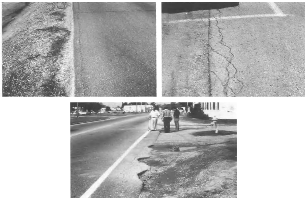
Gambar 2. 14 Retak tepi/samping (L, M, H)
