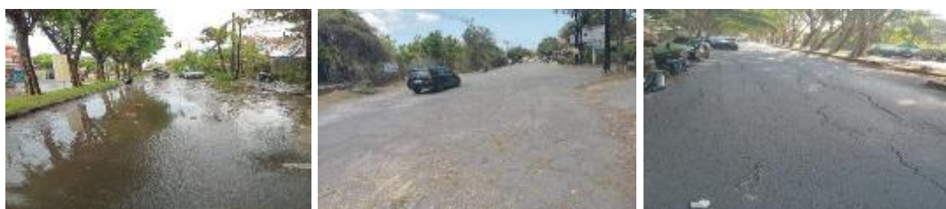
Gambar 3. 2 Kerusakan Jalan Puri Gading Sumber: Dokumentasi Penulis
