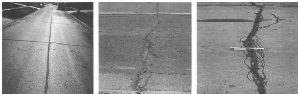
Gambar 2. 16 Retak Sambungan (L, M, H)
