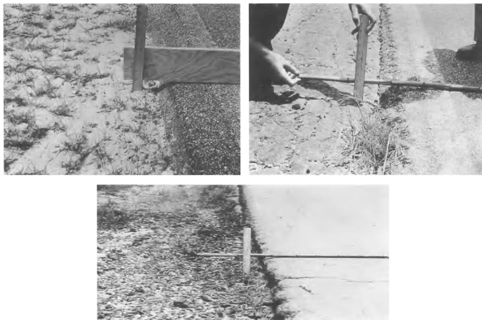
Gambar 2. 18 Penurunan bahu jalan (L, M, H)
