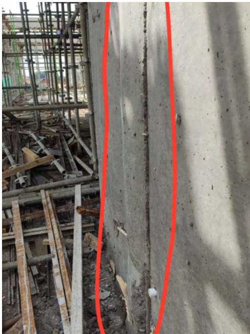
Joint Dinding Lift As 10/K-L pada bagian kanan tidak rapi
