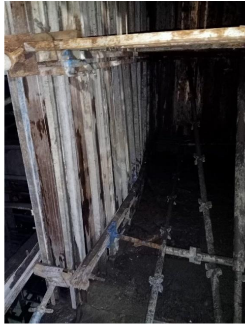
Besi support bekisting yang patah pada dinding lift As 10/K-L.
