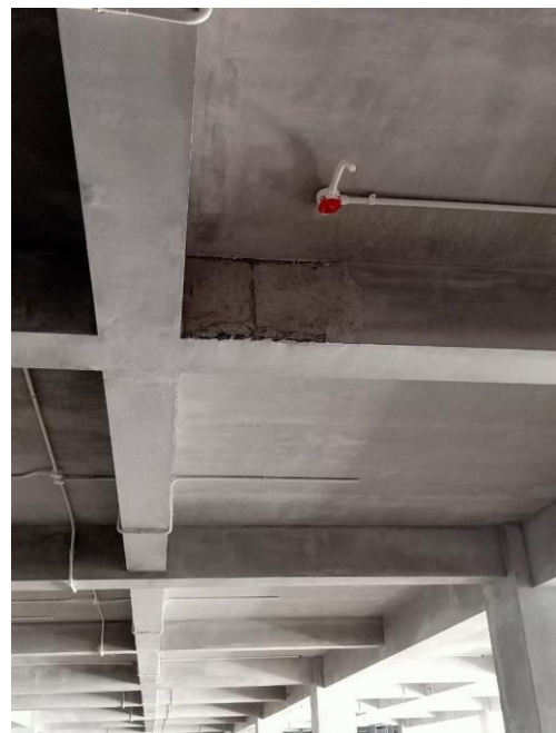
Bagian balok B3 as 5-6/J-K ada yang keropos
