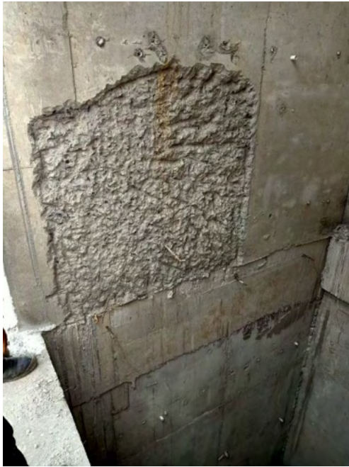
Hasil pembobokan dinding lift As 10/K-L yang melendut.
