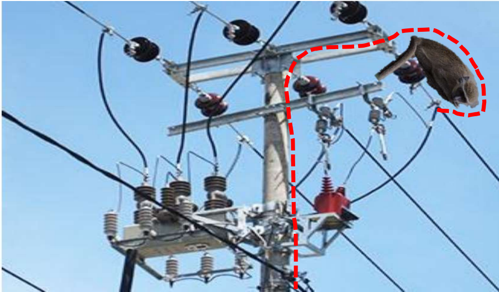
Gambar 12. Gangguan Satu Fasa Ke Tanah Karena Monyet di LLC Recloser
